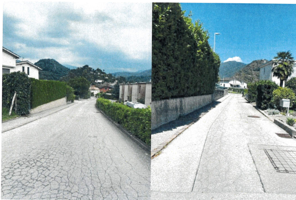
Esempi dello stato generale di Via Dragoni
